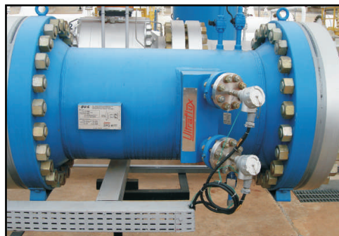
montagem em carrtel - sondas intrusivas
